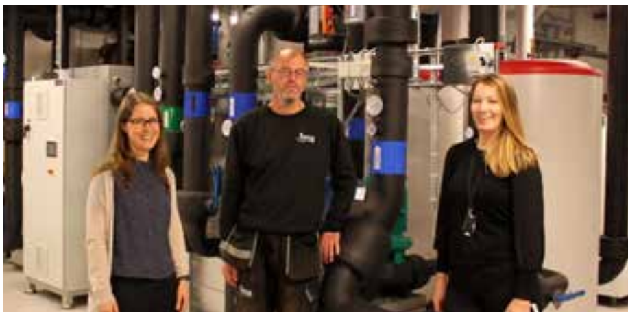
Nærnullenergiskole: Magnhild Kallhovd, (t.v), teknisk prosjektleder, og Rita Barkholm, energiledelse-skoordinator, i Undervisningsbygg, sammen med Sveinung Daae Olsen, vaktmester ved Brynseng skole.
