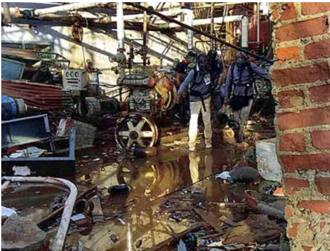
Det ammoniakk kjølte kuldelageret ble totalt ødelagt
