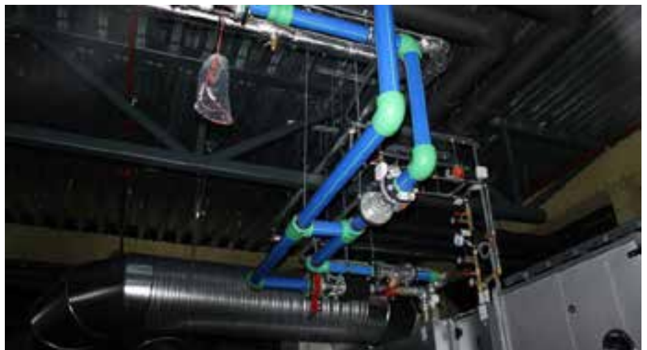
Viser kobling av stort kjølebatteri på aggregat.
